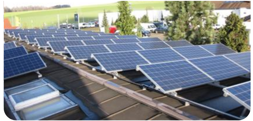
Aufständerung auf Bäckereibetrieb Nestler, Zschopau, 30kWp
