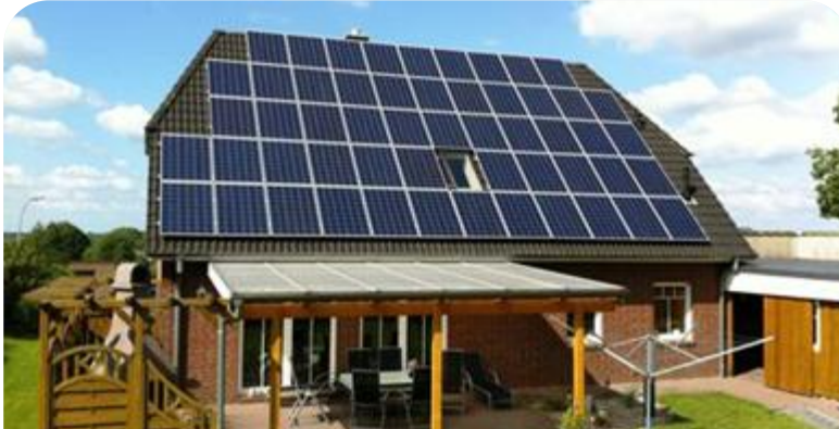
Aufdachanlage mit Edelstahlhaltern, 10,8kWp
