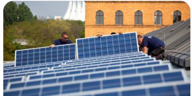
PV-Anlage auf Deutschen Technikmuseum Berlin, 46 kWp
