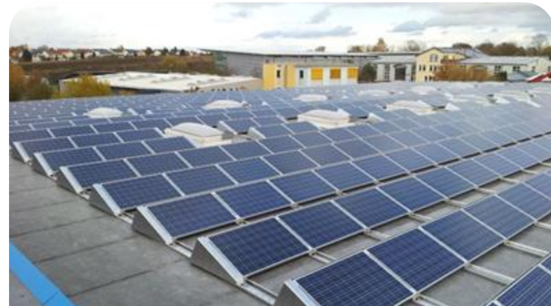
Aufständerung auf Fertigungshalle, 139,75 kWp
