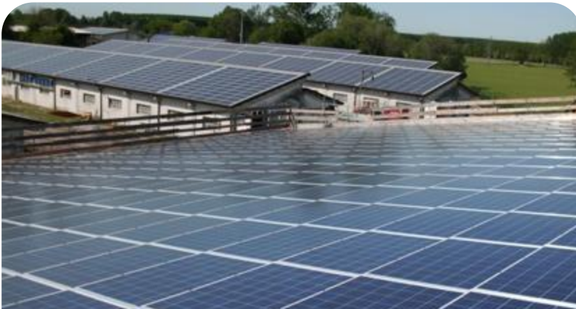
Indachanlage SOLRIF® auf Agrarbetrieb, 346,5 kWp
