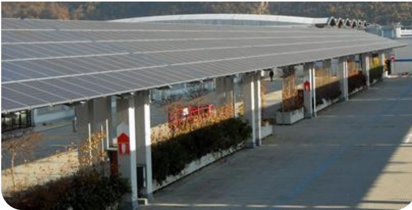
Solaranlage auf Messeparkplatz Bozen (IT), 303 kWp
