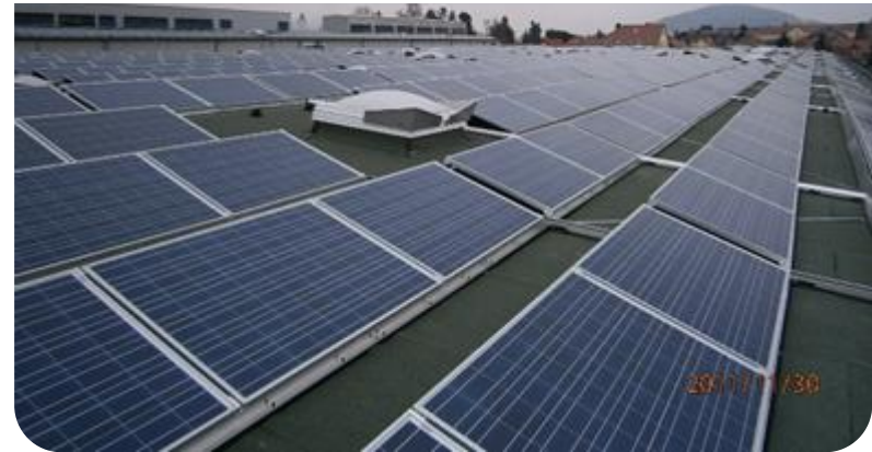
Flachdachanlage auf Industriegebäude, 342,76 kWp
